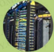
光纤通信机房
